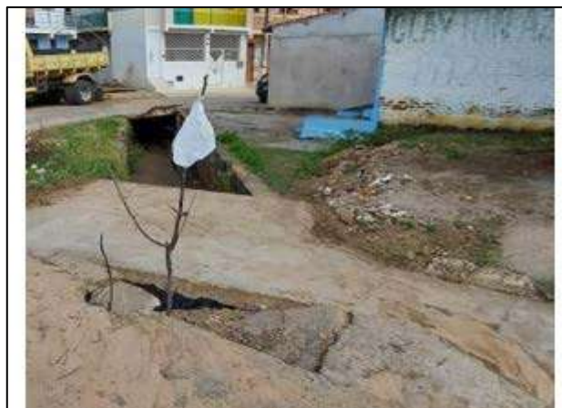
Figura 99 - Canal de drenagem danificado no bairro Joaquim Romão
