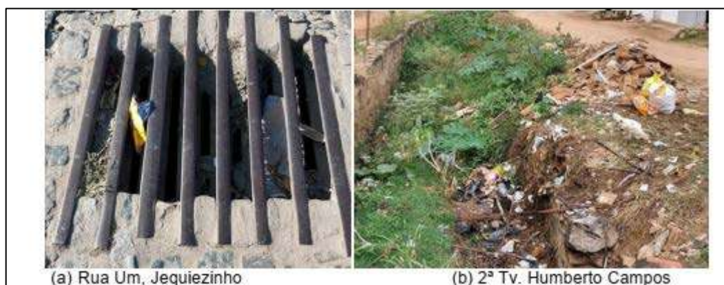
Figura 98 - Presença de resíduos no sistema de drenagem
