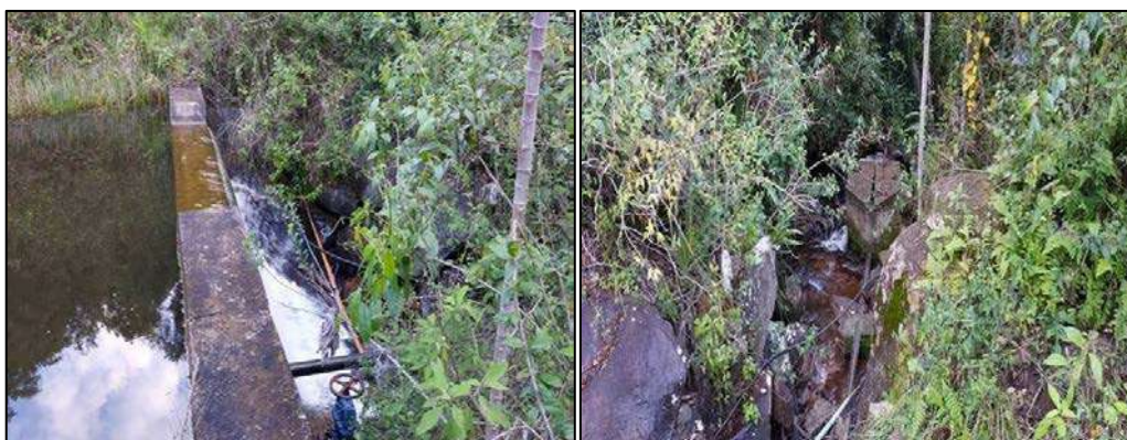
Figura 26 - Captação de água da represa do Rio Riachinho
