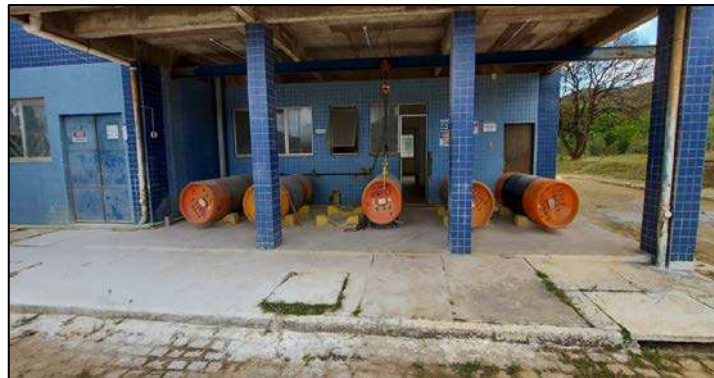
Figura 15 - Cilindros especiais contendo cloro liquefeito (ETA de Pedras)
