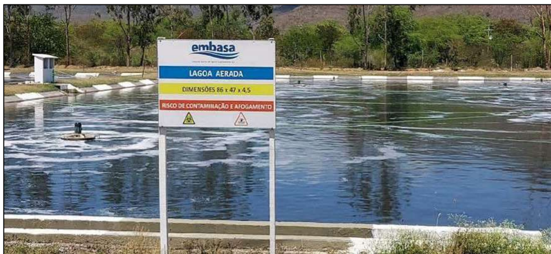
Figura 68 - Lagoas de estabilização – SES Jequié - Lagoa Aerada Facultativa
