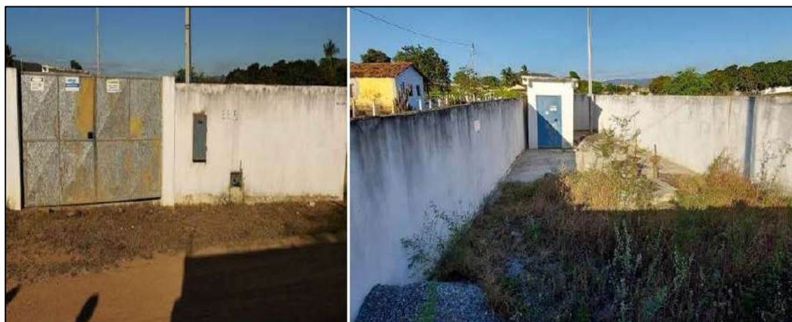
Figura 56 - Estação Elevatória de Esgoto 05
