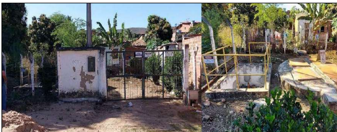
Figura 58 - Estação Elevatória de Esgoto 07
