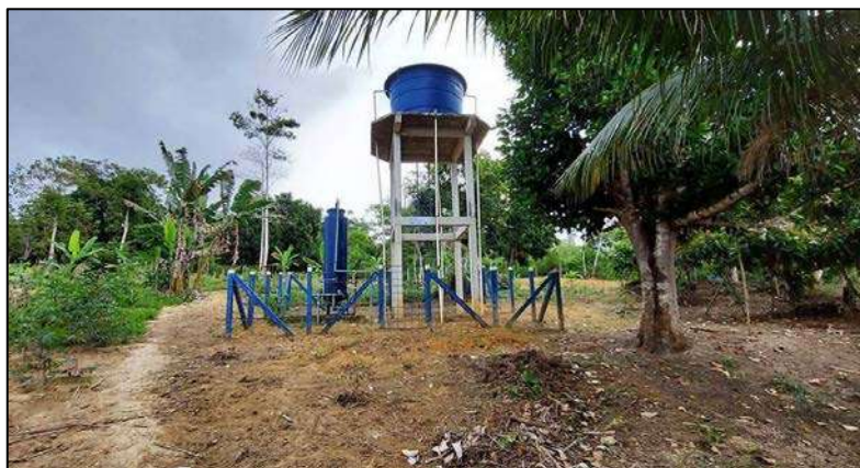
Figura 24 - Filtro redutor de ferro e reservatório elevado
