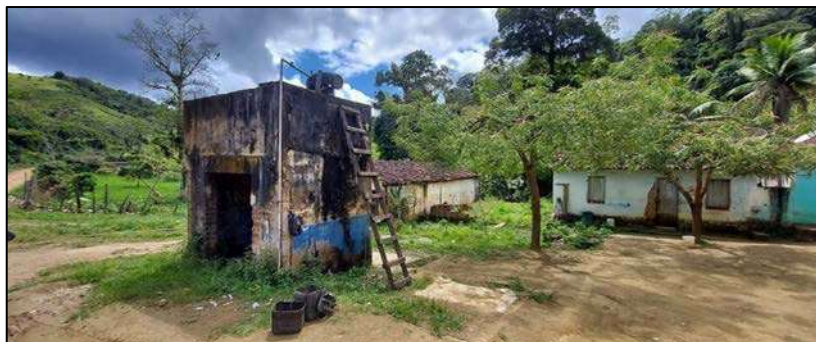
Figura 35 - Reservatório elevado de distribuição da água captada da nascente
