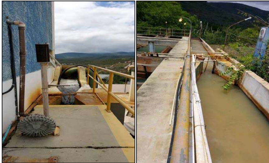
Figura 11 - Calha Parshall da ETA Criciúma (esquerda) e da ETA de Pedra (direita)
