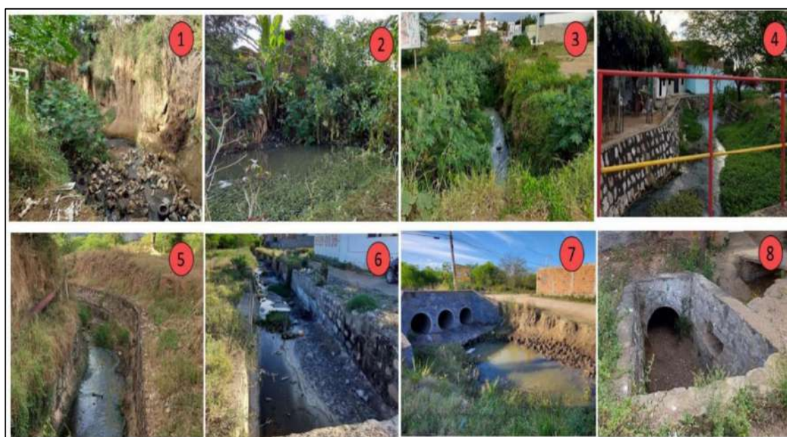
Figura 86 - Lançamento de esgotos no sistema de drenagem na sede municipal de Jequié/BA
