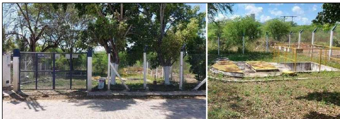
Figura 59 - Estação Elevatória de Esgoto 08
