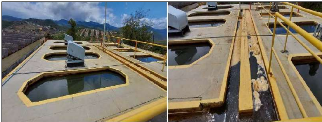
Figura 12 - Floculadores do tipo mecânico (ETA Criciúma)
