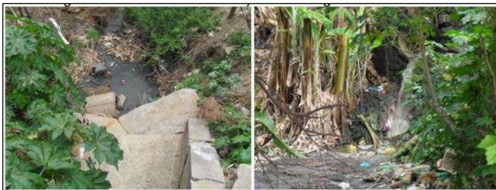
Figura 100 - Erosão de talude e lançamento de esgotos no Rio das Contas
