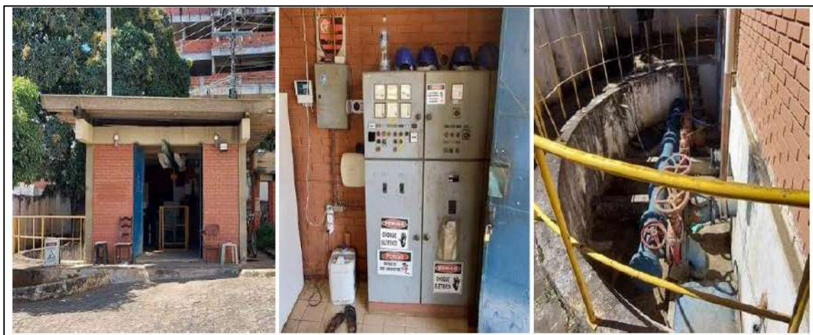
Figura 49 - Estação Elevatória de Esgoto 01 Jequié.
