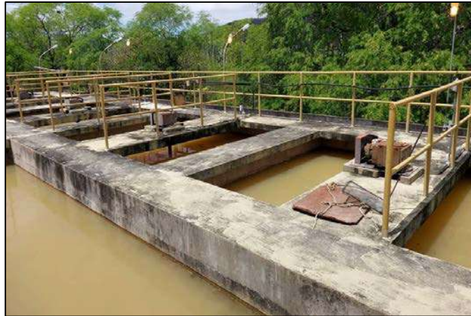
Figura 13 - Floculadores do tipo mecânico (ETA de Pedra)
