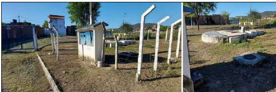
Figura 52 - Estação Elevatória de Esgoto 04
