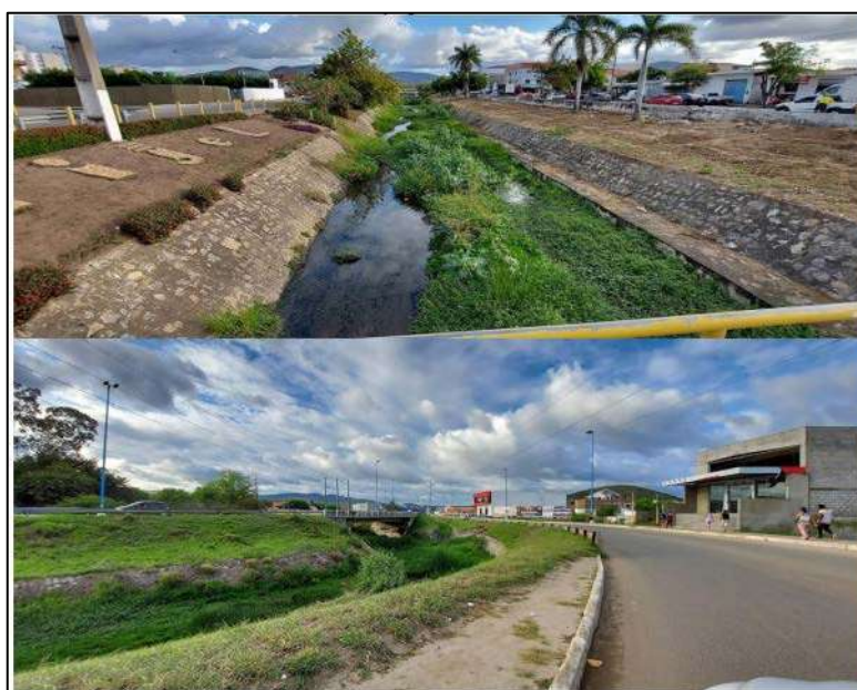
Figura 102 - Canalização (Impermeabilização) das margens e degradação do Rio
