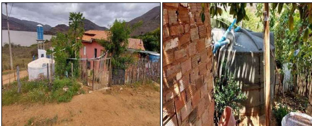
Figura 37 - Cisternas implantadas no Distrito de Monte Branco
