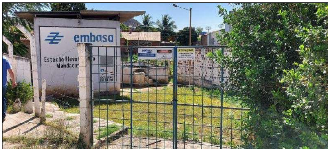
Figura 60 - Estação Elevatória de Esgoto 09
