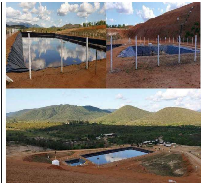
Figura 136 - Unidade de tratamento de percolados
