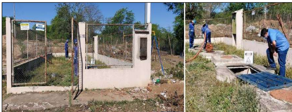
Figura 62 - Estação Elevatória de Esgoto 09B
