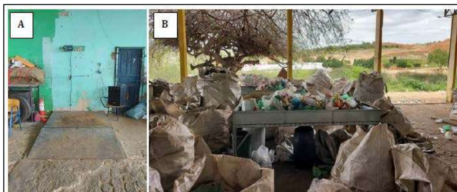
Figura 127 - Balança de pesagem (A) e esteira de triagem e seleção dos materiais (B)
