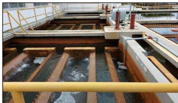
Figura 14 - Filtros (ETA Criciúma)
